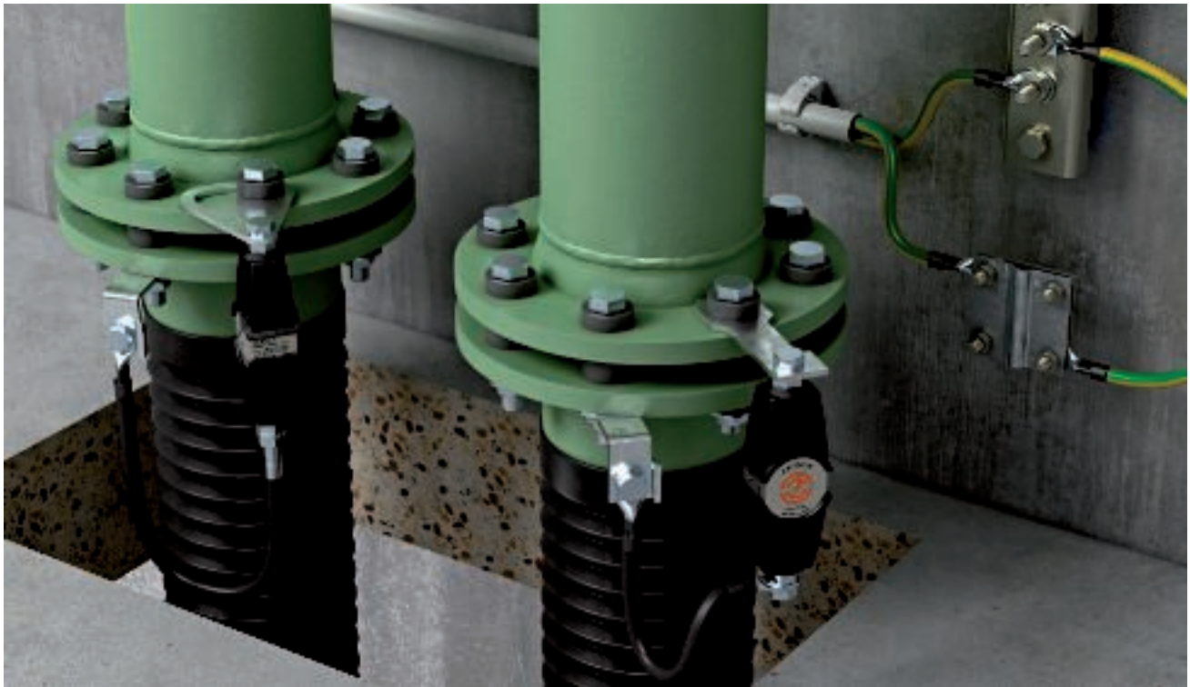
Trennfunkenstrecke an Isolierstücken montiert
