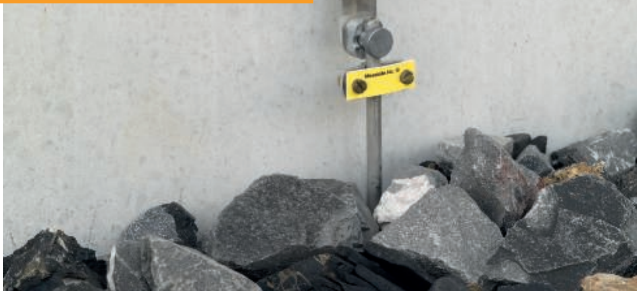
Messstelle an der Erdeinführung
