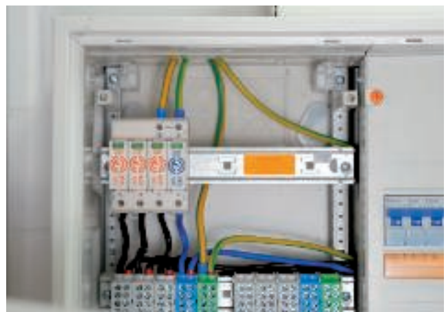
Montage des Typ 1+2 Kombiableiter V50 im oberen Zähleranschlussraum
