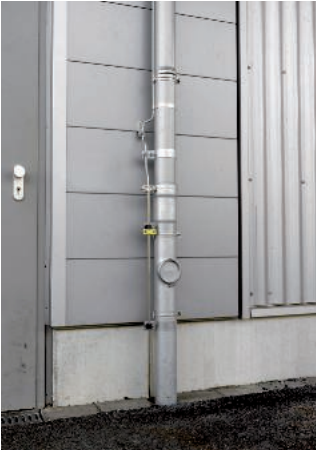
Blitzschutzableitung an einem Regenfallrohr
