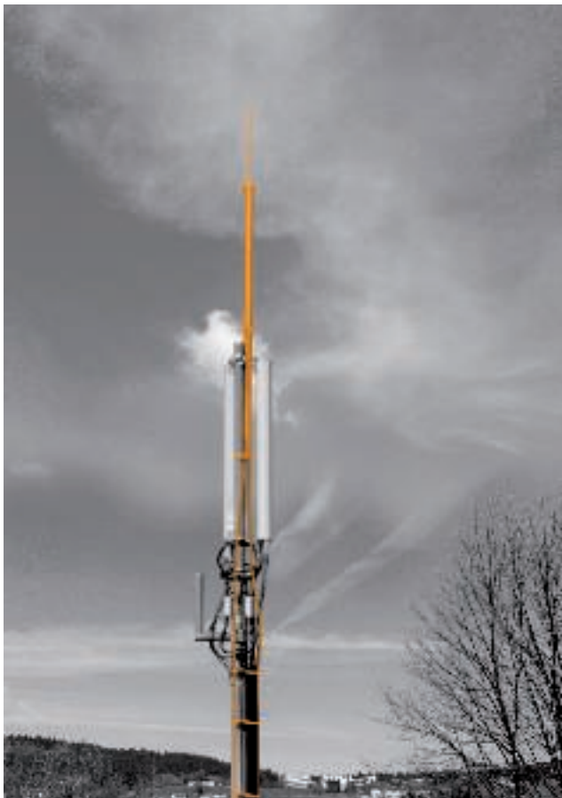
Mobilfunkmast mit isCon®-Ableitung
