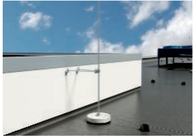
Getrennter Blitzschutz mit Isoliertraversen
