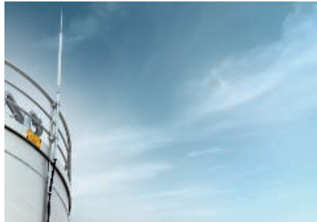
Getrennter Blitzschutz mit isCon®
